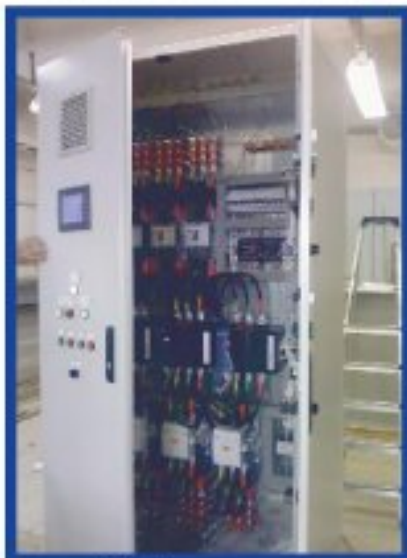
Шкаф автоматики станции биологической очистки
